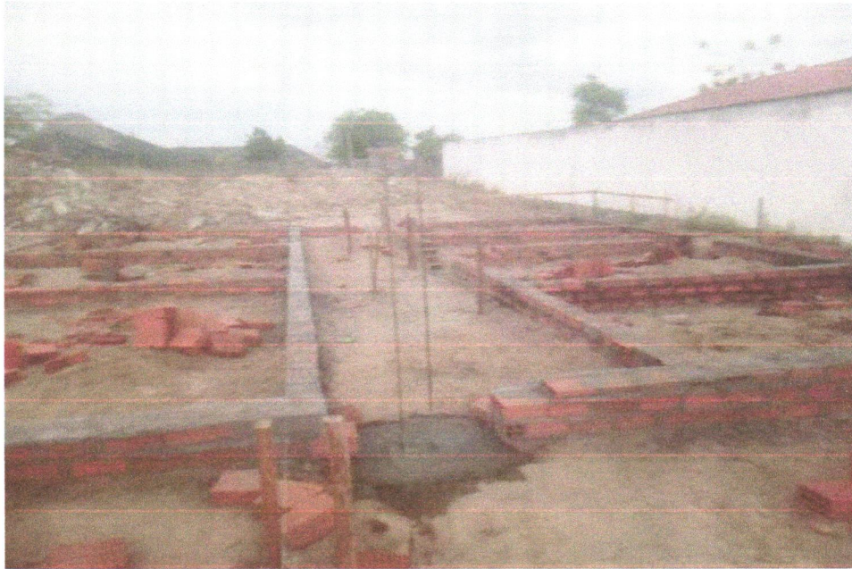
FOTO 07 – ESCAVAÇÃO MANUAL DE VALA PARA VIGA BALDRAME (INCLUINDO ESCAVAÇÃO PARA COLOCAÇÃO DE FÔRMAS). AF_06/2017
